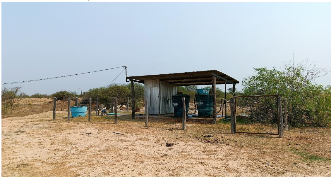
Sistema de tratamiento de agua en la Colonia María Auxiliadora
