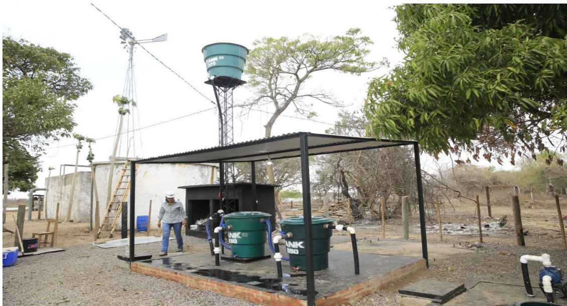
Sistema de tratamiento de agua en la comunidad Cucaani
